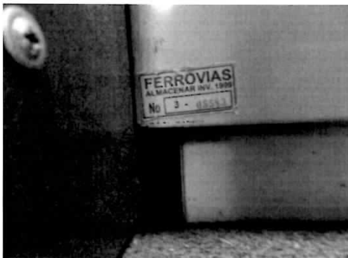
Placa de Ferrovías
